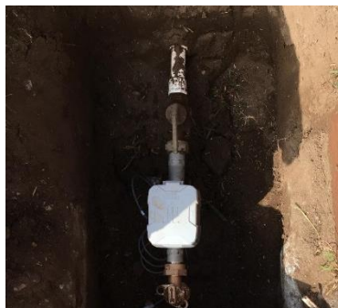
Un medidor de agua CVWD con una línea de servicio CVWD de cobre y una línea de servicio al cliente de PVC (plástico)
